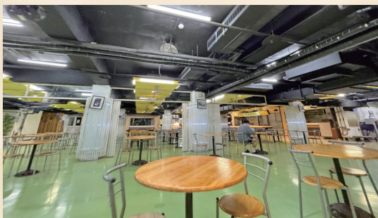
▲ 大量空調風管外露於天花板，並採深色塗裝處理，使空間呈現低矮、壓迫且沉重的視覺感受。（達觀設計公司提供）
